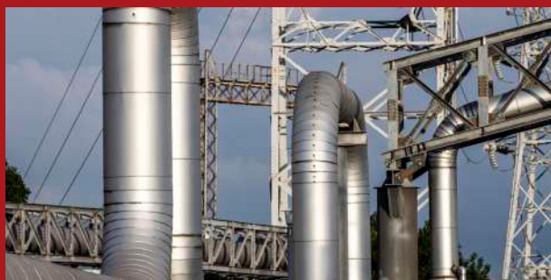
Теплоснабжение и энергетика
